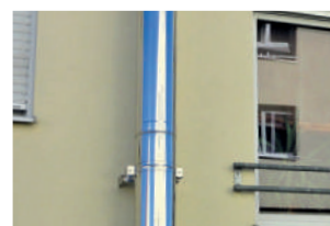
Tubos de chimenea
