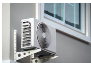
Unidades exteriores de aire acondicionado
